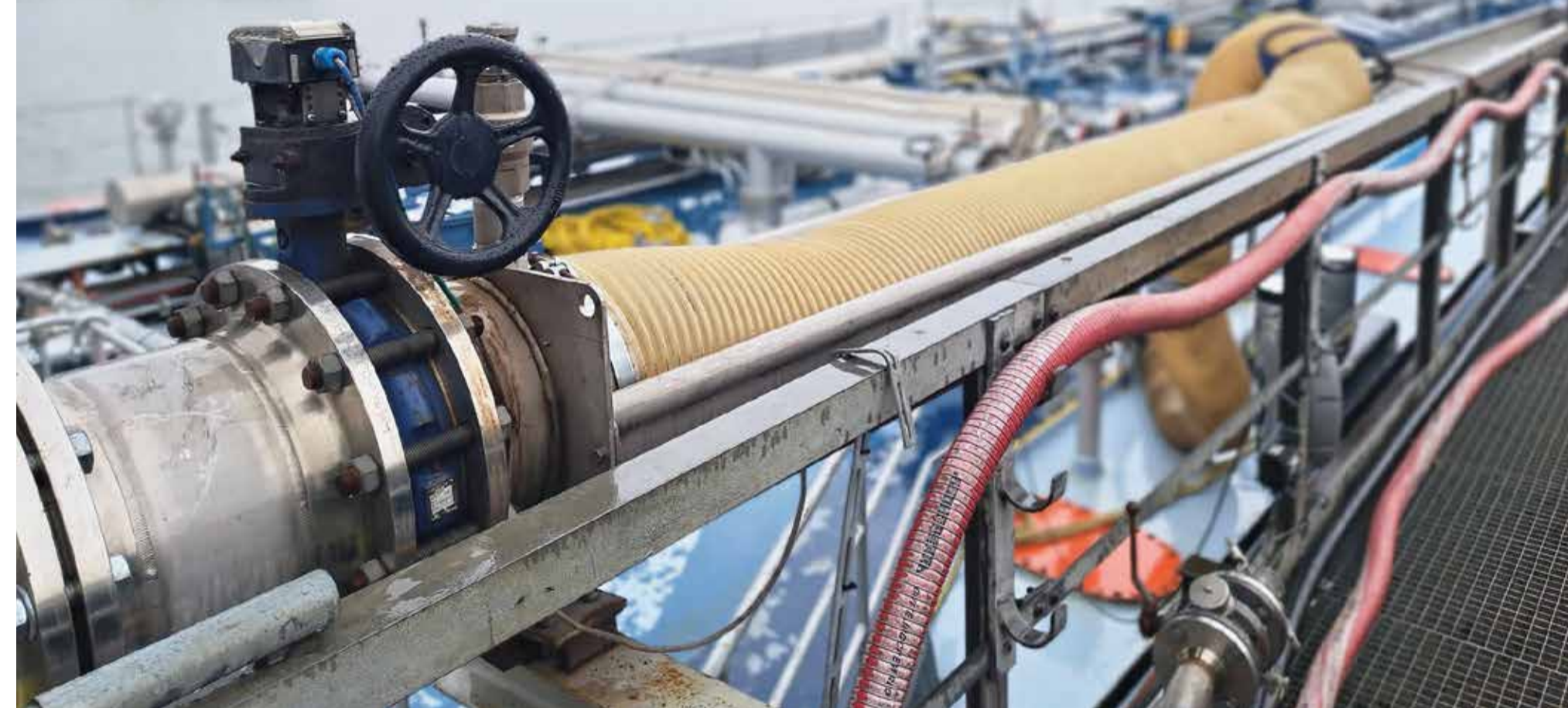
Een tankschip aan de ontgassingsinstallatie bij ATM in Moerdijk. Voorlopig nog de enige ontgassingsinstallatie voor de binnenvaart. Foto Esther Geerts
